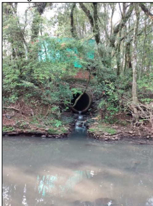
Figura 71 – Lançamento de esgoto bruto no Arroio Tarimba – margem Campo do 15.
