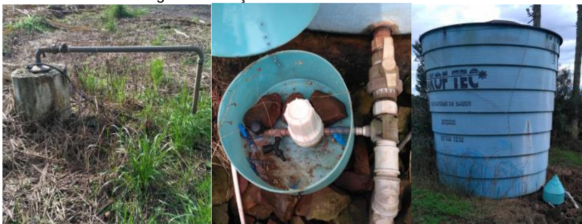
Figura 61- Poço Comunidade Volta Grande
