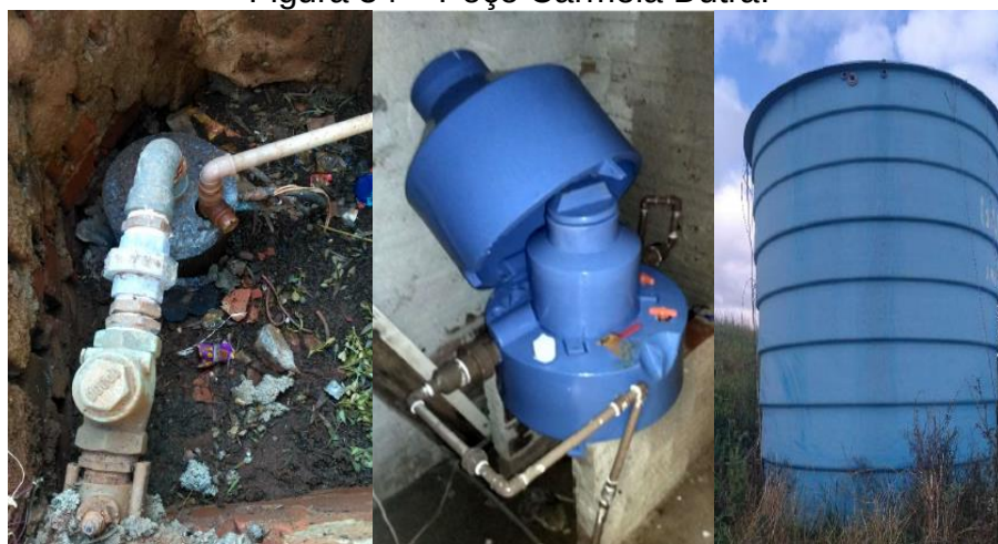
Figura 54 – Poço Carmela Dutra.
