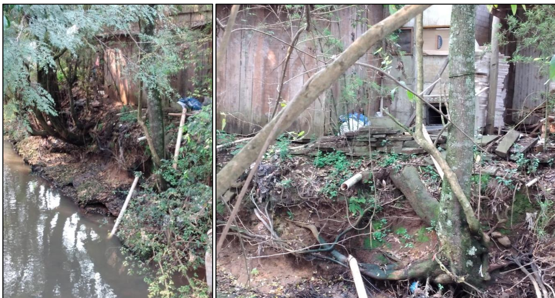
Figura 76 – Lançamento de esgoto bruto no Arroio Porongo – próximo ao Posto de Saúde
