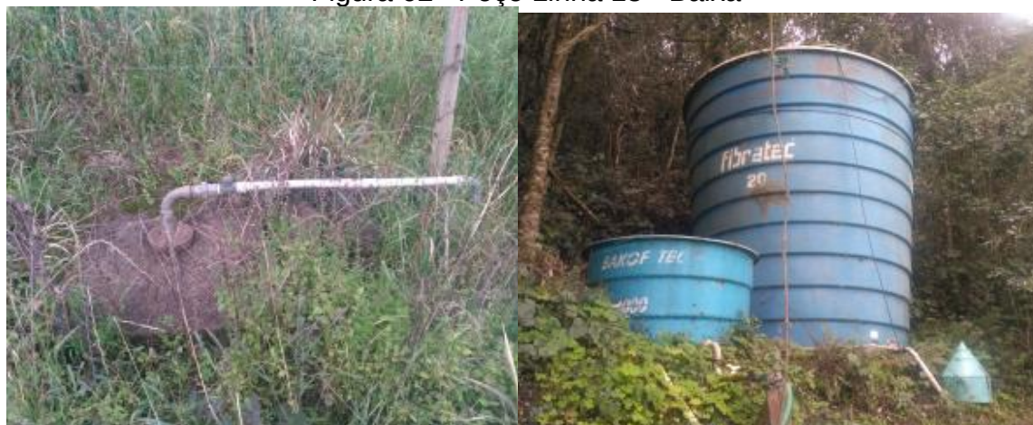
Figura 62– Poço Linha 18 - Baixa
