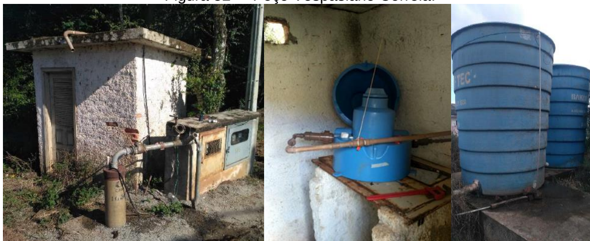
a) Poço de captação; b) Tratamento. Fonte: Vila Maria (2020).
