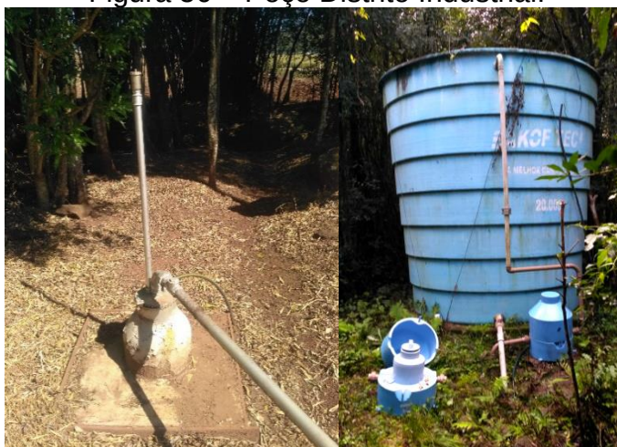
a) Poço de captação; b) Tratamento; c) Reservatório. Fonte: Vila Maria (2020).
