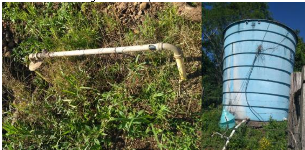
a) Poço de captação; b) Tratamento; c) Reservatório. Fonte: Vila Maria (2020).
