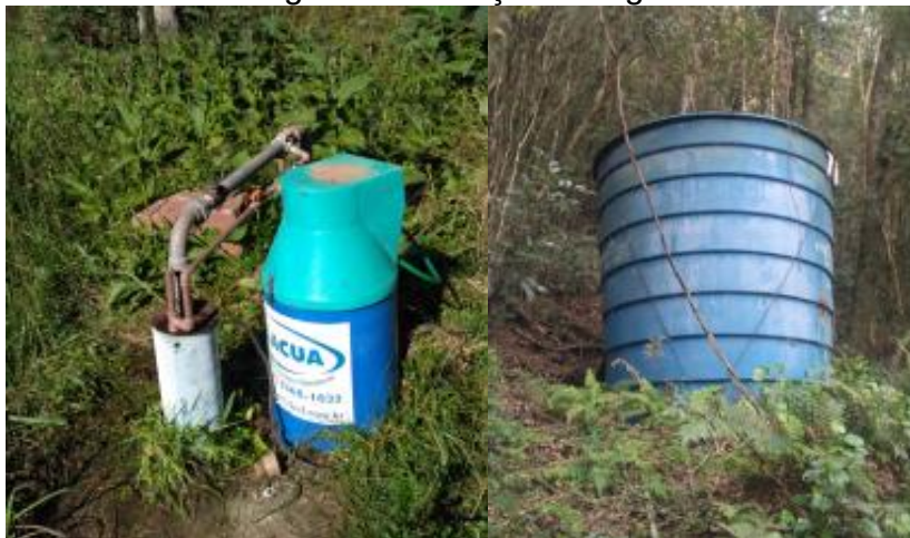
a) Poço de captação; b) Reservatório. Fonte: Vila Maria (2020).
