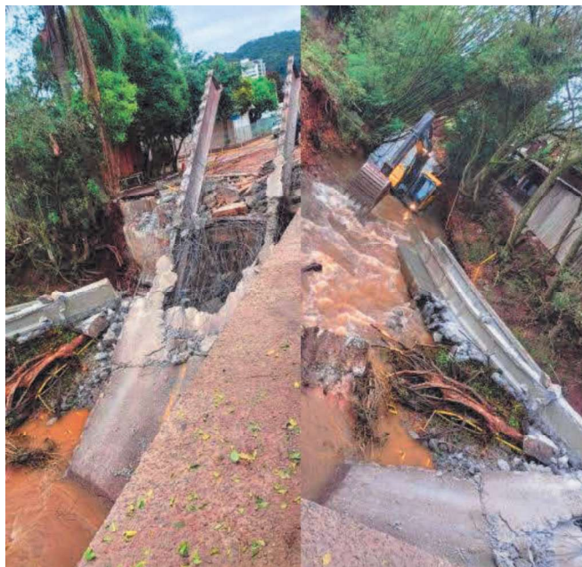
Figura 57 – Danos em travessia e estruturas de drenagem/ponte, com necessidade de intervenção de máquinas (Fonte: Vila Maria, 2026)
